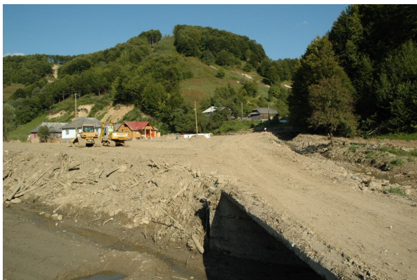
Fig.10. Lucrări de nivelare a conului de dejecție deșus de la gura pâraului Uleasa.
