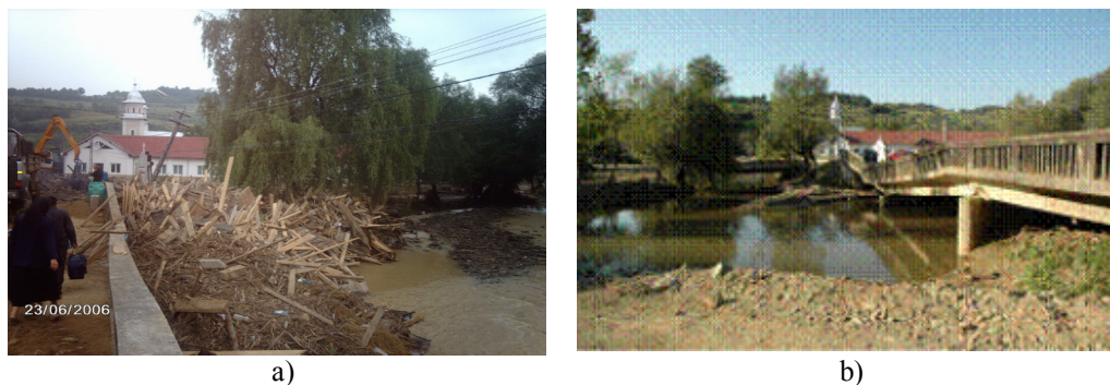
Fig.2. Târlișua: a) stivă de materiale lemnoase acumulate în urma viiturii de pe Valea Izvorului, în spatele podului principal (imagine preluată la trei zile de la viitură); b) podul principal, avariat în urma viiturii de pe Valea Izvorului.
