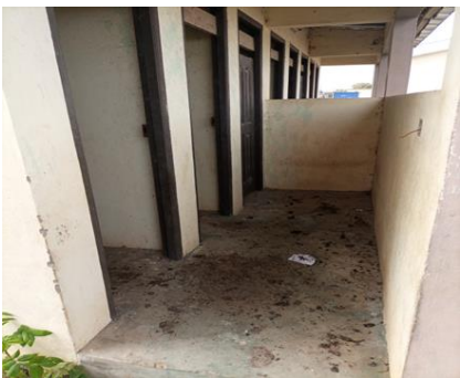
c) Un bâtiment abritant des latrines collectives non entretenues à l'EPP Taabo-village.
