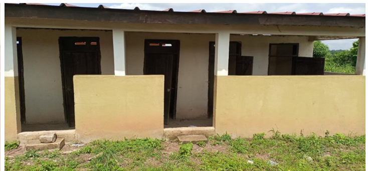
D) Un bâtiment de six latrines en état délabré à l'EPP Séguié
