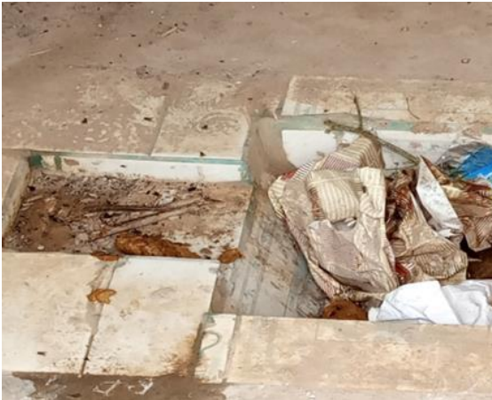
A) Latrine à fond perdu bouchée par les déchets solides à l'EPP Séguié
